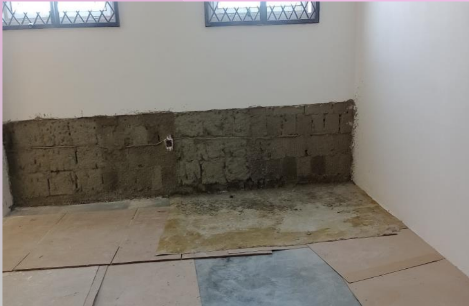
Poškodená podlaha v novom depote
