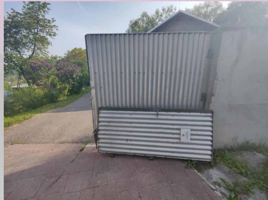
Poškodená vstupná brána do areálu
