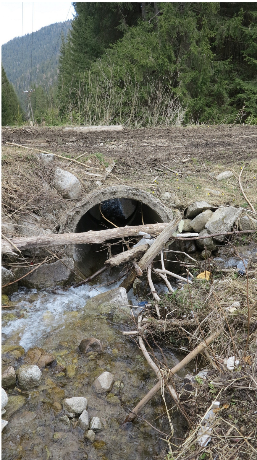
Obr. č.3. Nevyhovujúci rúrový priepust na lesnej približovacej ceste
