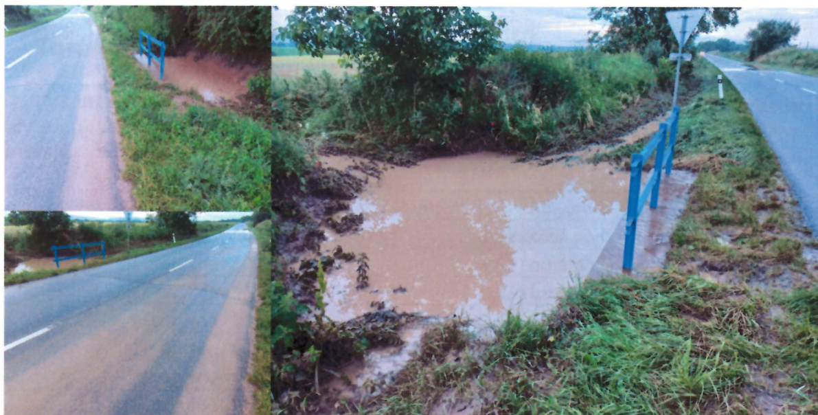
Obr. 6. Zapchatý a zaplavený priepust pod cestou III/1311
