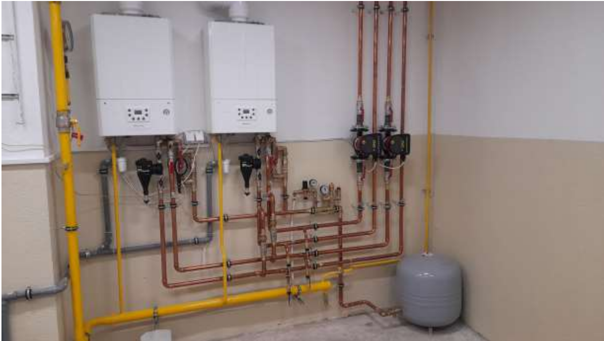
Kotolňa – plynové kotly
