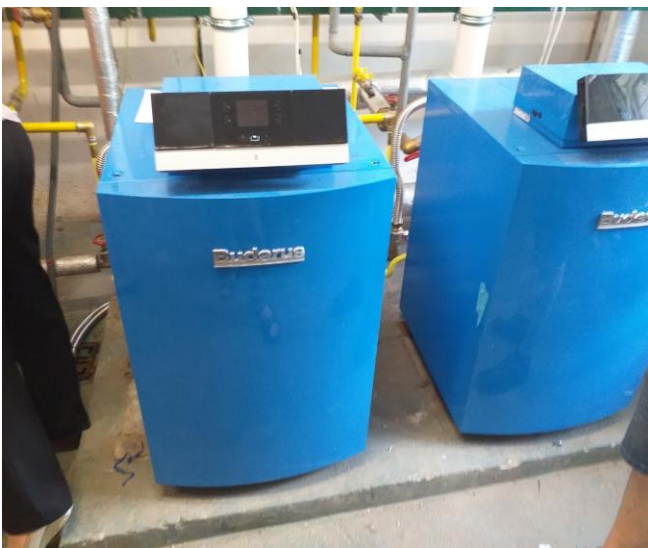
Zariadenie plynovej kotolne
