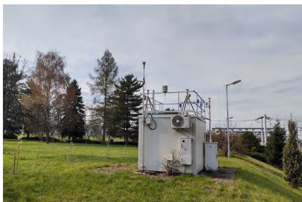
Obrázok 3 - Pohľad na stanicu Bystričany - Rozvodňa SSE
