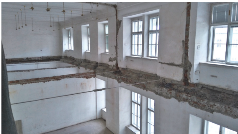
OBRÁZOK 1 – Hlavné krídlo budovy SBA počas rekonštrukcie. Zdroj: MV SR SNA, špecializované pracovisko SBA.
