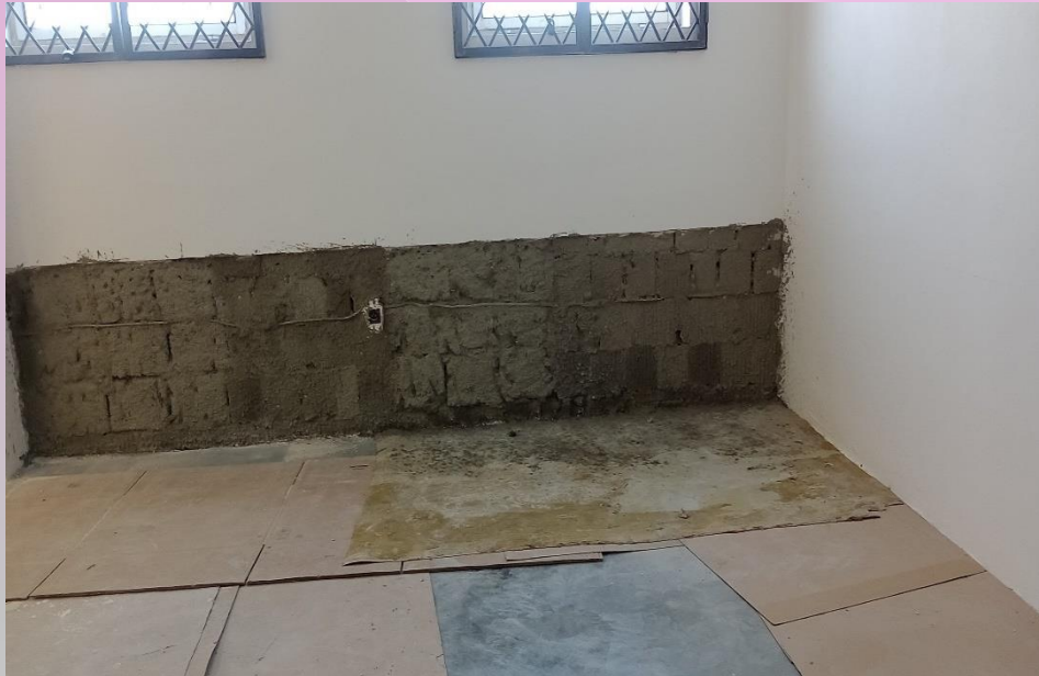
Poškodená podlaha v novom depote
