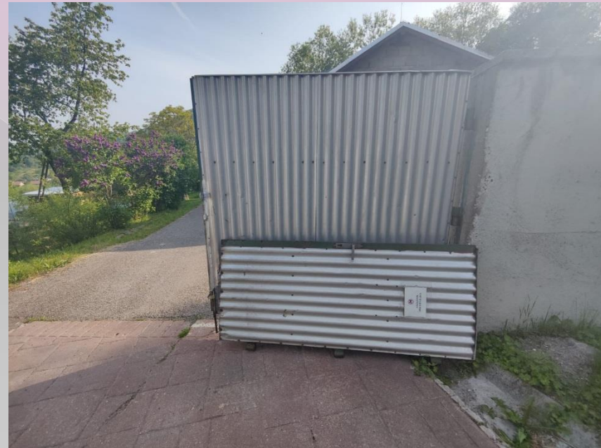
Poškodená vstupná brána do areálu
